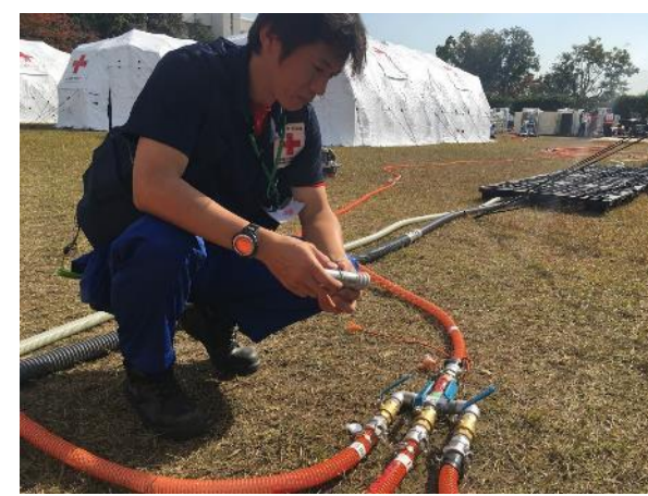
水・衛生設備
